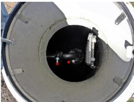
Blick in den Schacht der Geothermieanlage © osradio
