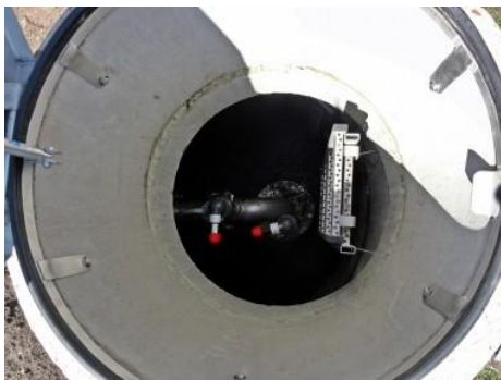
Blick in den Schacht der Geothermieanlage © osradio
