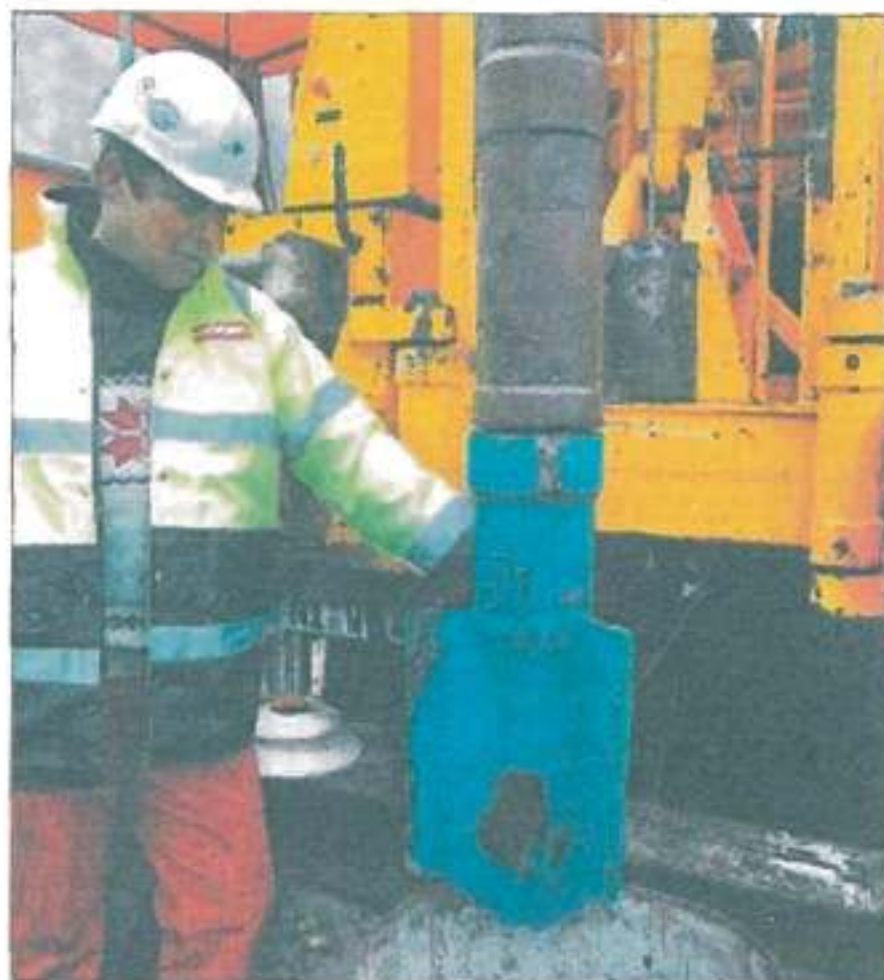
Mario Rolles von der am Projekt beteiligten Nienburger Wöltjen-Gruppe setzt den Bohrkopf in Betrieb: Elf Meter sind schon geschafft, 400 Meter Tiefe sollen es werden. Fotos: Grulke
